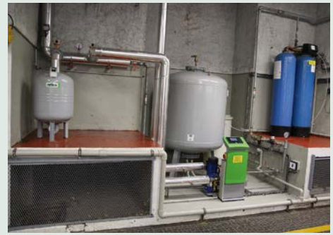
La chaufferie centralisée est elle-même équipée d'un groupe de maintien de pression pour combattre les variations liées à la taille de l'installation avec ses trois kilomètres de réseaux. Un adoucisseur est également prévu pour l'eau de chauffage.
