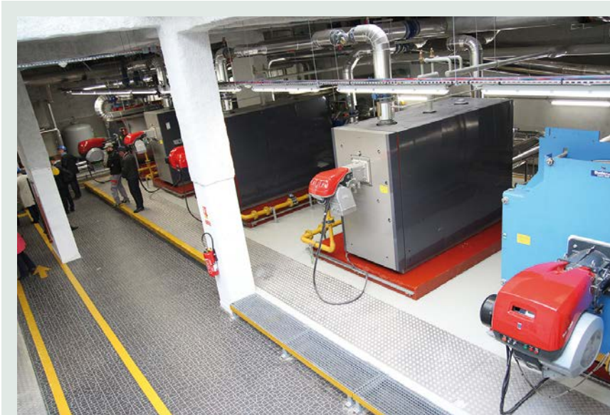
Une des chaudières anciennes avait été changée en 2011 à la suite d'une panne dans l'ancienne chaufferie. De marque Buderus, elle délivre 6 MW mais n'est pas une chaudière à condensation. Dans la nouvelle installation, elle a cependant été conservée en secours.
