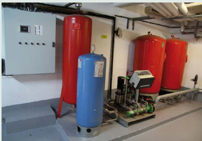
Naturellement, le réseau hydraulique bénéficie d'un traitement de l'eau et d'un surpresseur pour vaincre la perte de charge des 28 étages.
